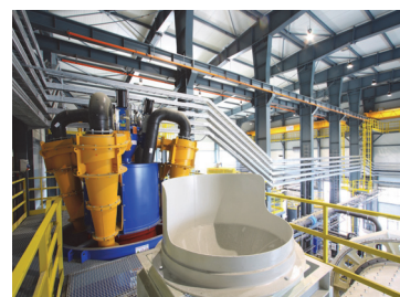
Zakład Przerobu Odpadów Poflotacyjnych dla ZGH Bolesław
