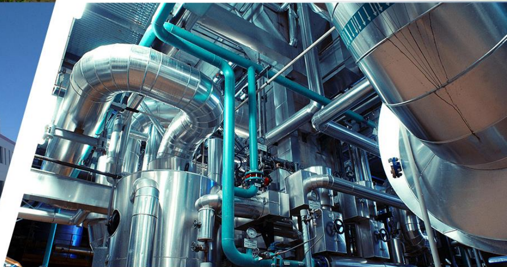
AUTOMATYKA I ELEKTROTECHNIKA
